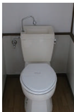
簡易水栓トイレ
