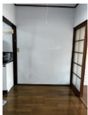
キッチン 冷蔵庫置場
