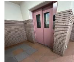
エレベーター
